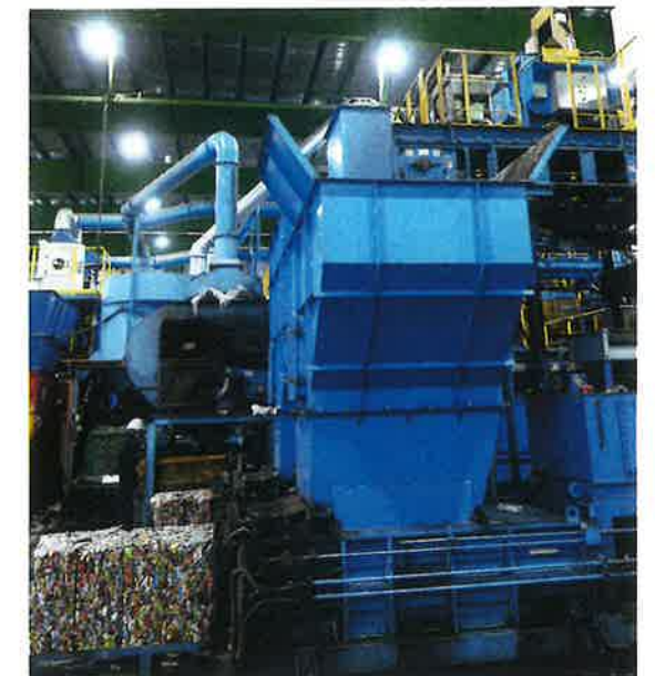
磁力選別機で吸着したスチール缶を圧縮するスチールプレス機
